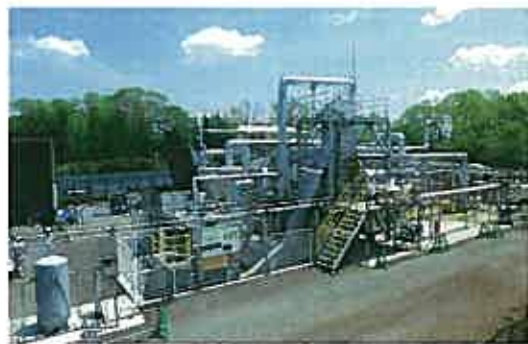
写真1 ■ 那須高原サービスエリア付近に設置したバイオマスガス発電プラント(写真:下の2点も東日本高速道路会社)
